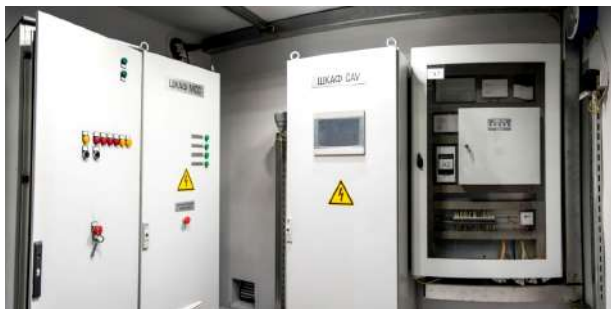
Рис. 4. Шкаф управления МКБ Fig. 4. Mobile compressor unit (control cabinet)
