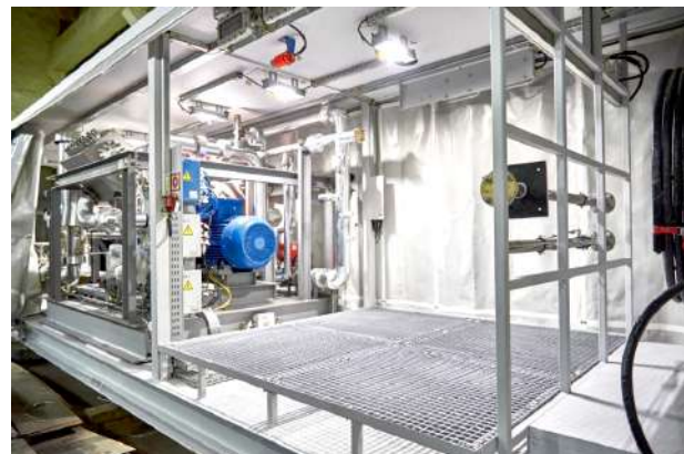
Рис. 3. Компрессорная установка МКБ (вид со стороны электродвигателя) Fig. 3. Mobile compressor unit (view from the side of the electric motor)
