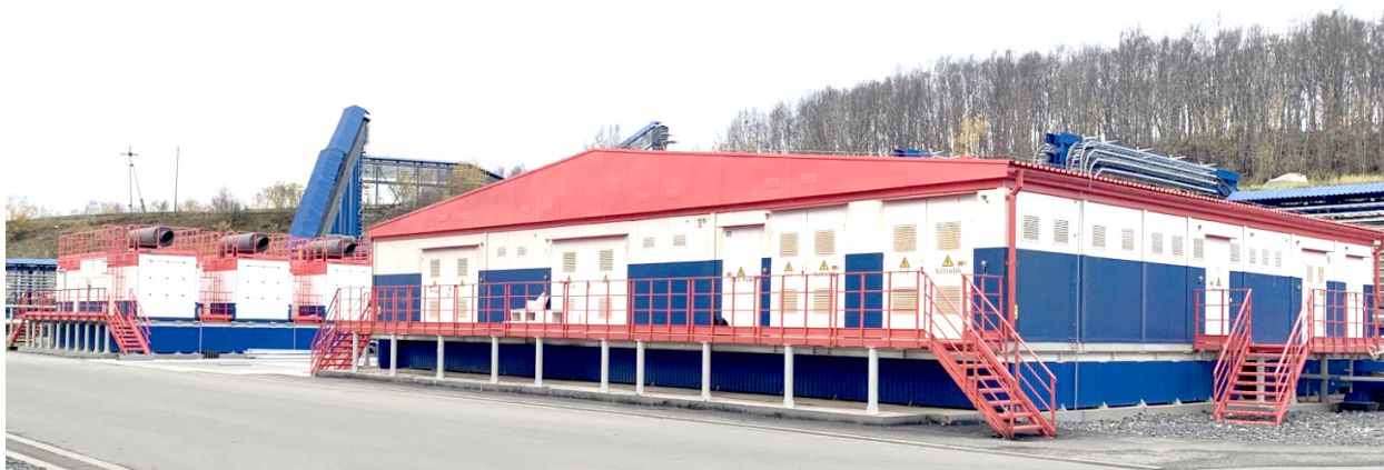
Рис. 1. Энергокомплекс подстанции с резервированием от газопоршневых генераторов Fig. 1. Substation energy complex with redundancy from gas piston generators
